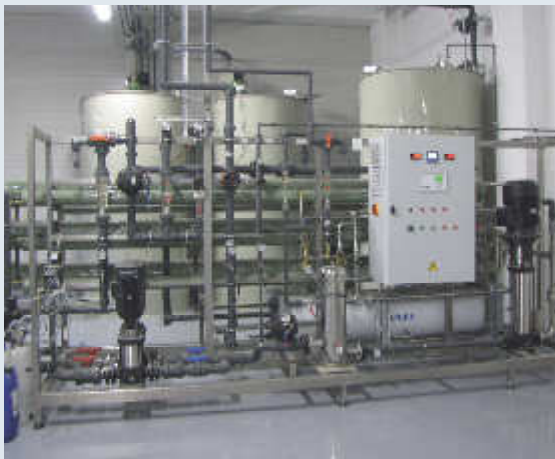
Instalacja odwróconej osmozy
